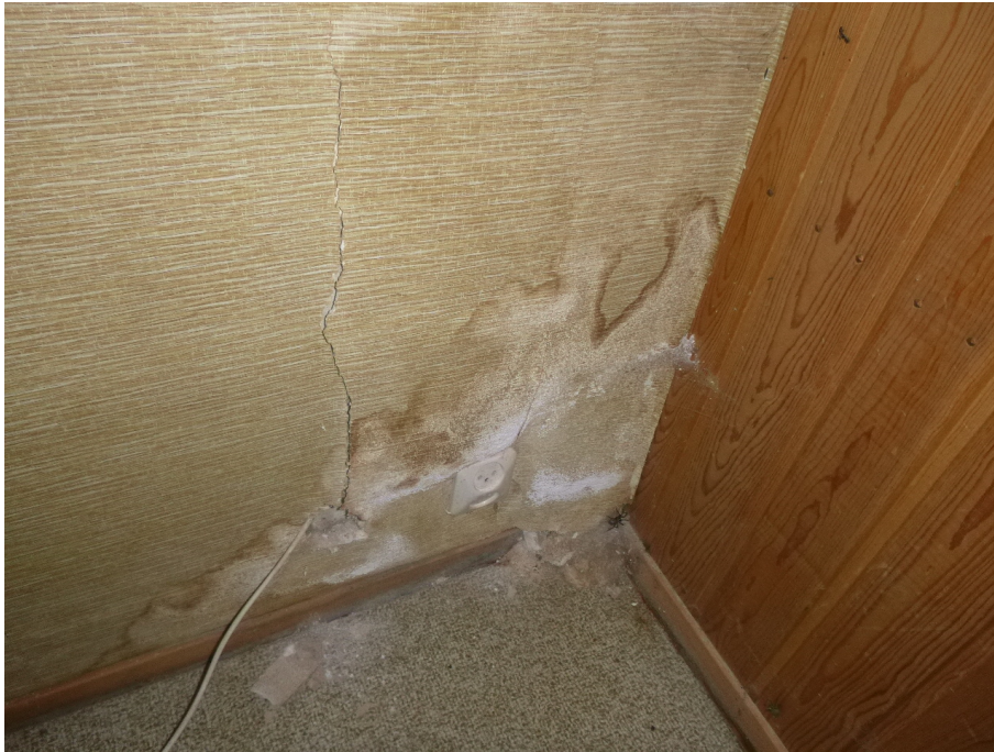
Fuktgenomslag genom yttervägg mot utsida, källarplan.
